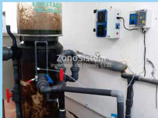
Ozono inyectado a skimmer de depuradora de ostras.
