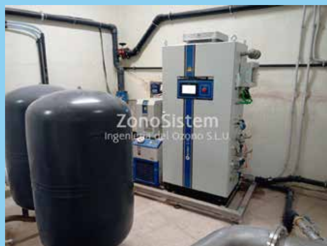
Desinfección de aljibe de agua de riego. Santiago Bernabéu. Madrid. España.
