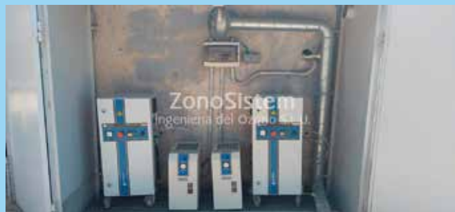
Ozonización profunda de pozos de bombeo paseo marítimo. Islas Baleares.
