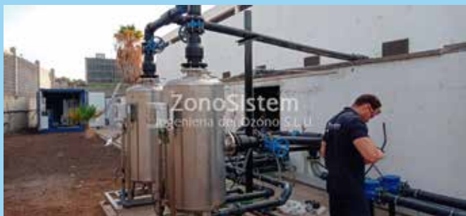
Ozonización profunda de pozos de bombeo directo a emisario. Islas Canarias
