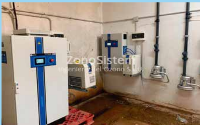
Ozonización profunda de pozos de bombeo. Islas Canarias.
