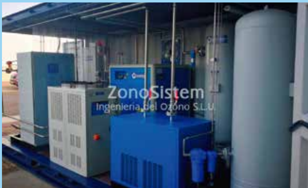
EDAR Urbana en Tenerife. Preoxidación.
