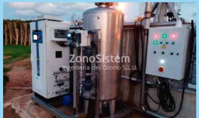
EDAR Urbana en Manacor. Tratamiento Terciario.
