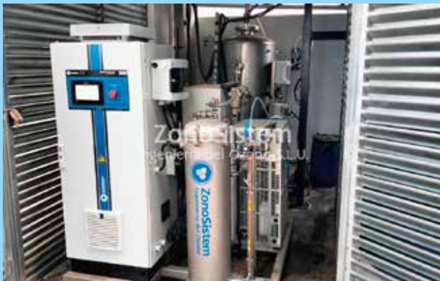
EDAR Urbana en Comunidad Valenciana. Preoxidación.
