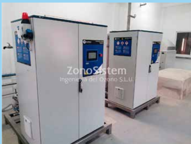
Ozono para ETAP en Almería. ETAP Bajo Almanzora.
