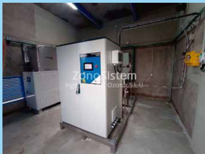
Ozono para ETAP en Extremadura. ETAP Llerena.
