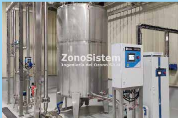
Aguas de proceso en bodega, la Rioja. España.
