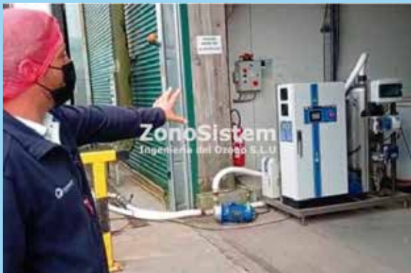
Ozono para lavado de zanahorias. Francia
