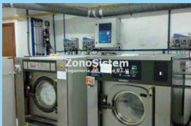
Ozono para Lavandería. Extremadura, España.
