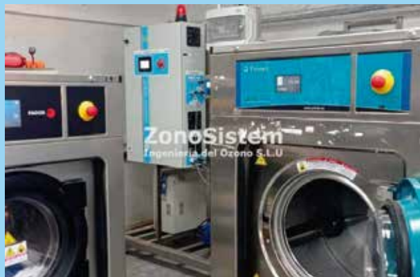
Ozono para Lavandería. Extremadura, España.
