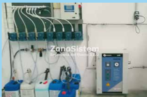
Ozono para Lavandería. Extremadura, España.
