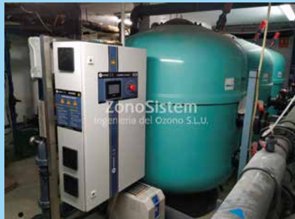
Ozono para piscina cubierta. Jerez-España.
