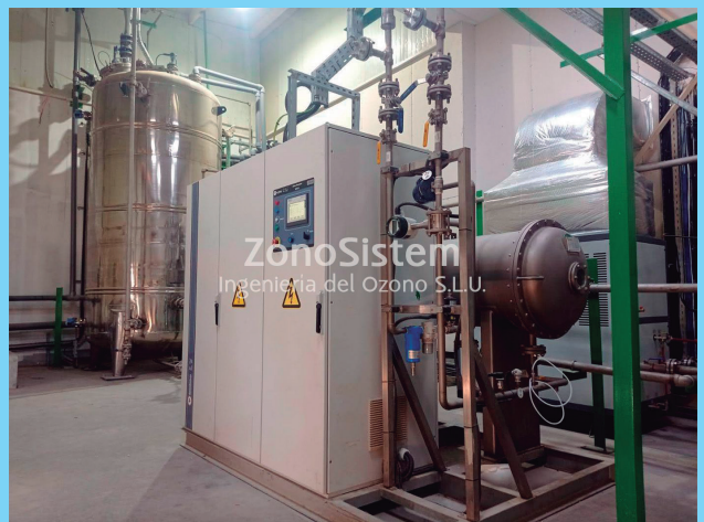
Preoxidación en industria petroquímica.
